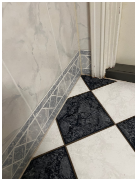
Silkonfuge overgang gulv/vegg er sprukket
