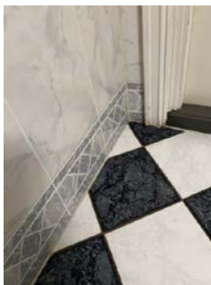
Silkonfuge overgang gulv/vegg er sprukket
