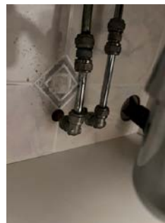
Utette rørgjennomføringer i servantskap
