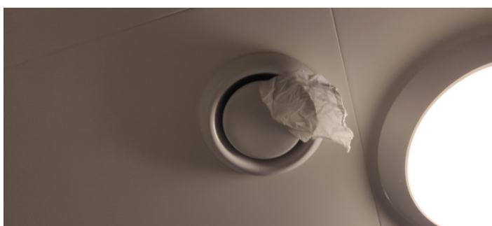
Funksjonstest av avtrekk.
