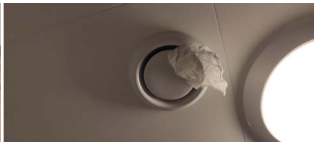
Funksjonstest av avtrekk.
