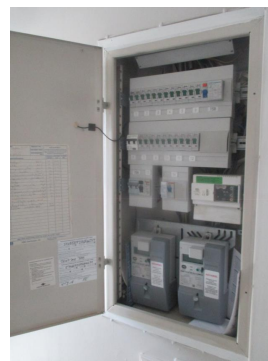
Felles sikringskap i fellesgangen.
