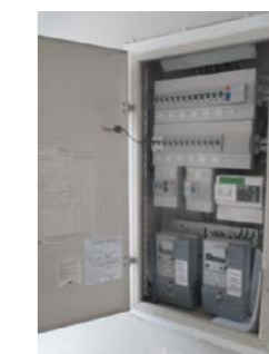
Felles sikringskap i fellesgangen.
