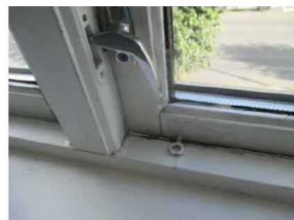
Noe innvendige kondensmerker.
