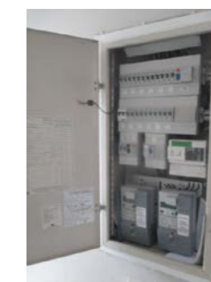
Felles sikringskap i fellesgangen.
