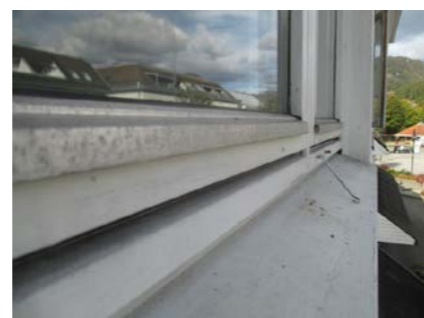
Trenger utvendig vedlikehold.
