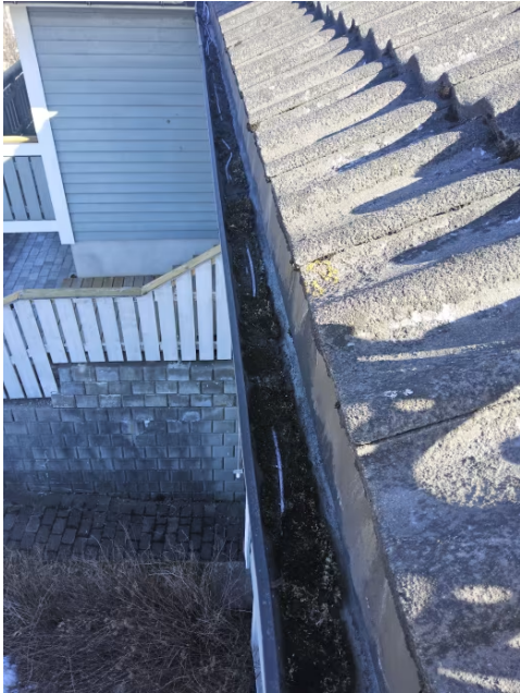
Det registreres oppbygging av mose i takrenner.
