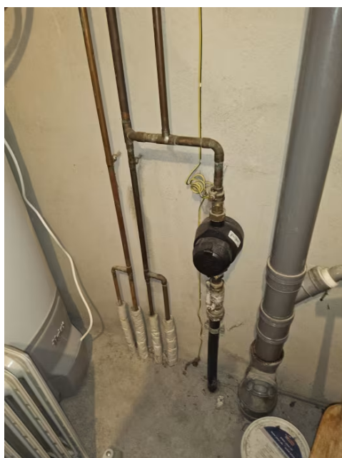
Hovedstoppekrane er plassert i bod i underetasje.
