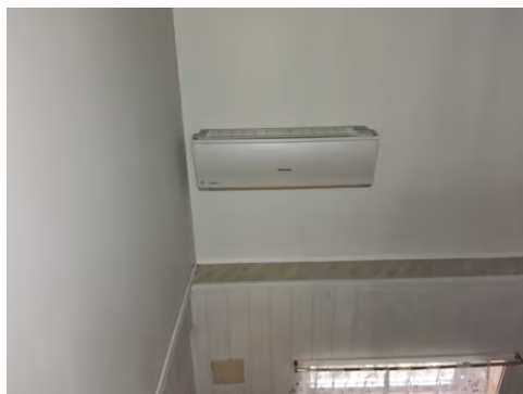
Varmepumpe i trappegang.
