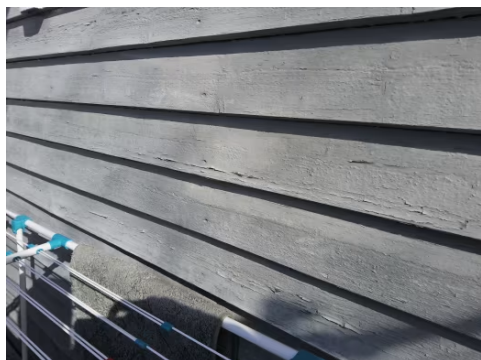
Deler av kledningen har krakelert maling.
