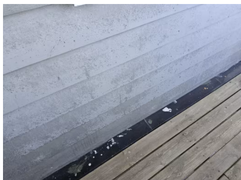
Svertesopp registreres på deler av kledningen.
