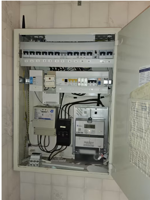
Sikringsskap er plassert på vaskerom.
