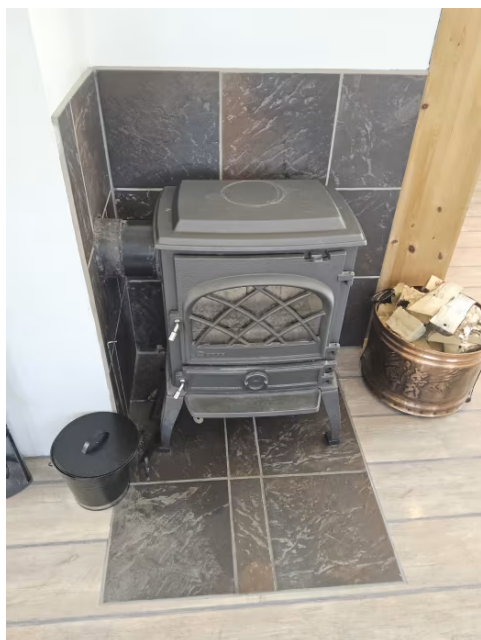
Vedovn med glassdør i stue.
