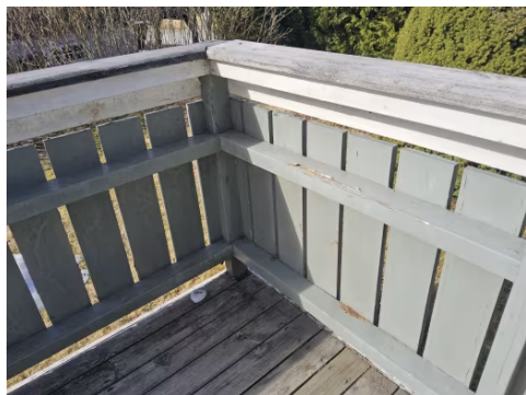
Terrasse med tilhørende rekkverk er værslitt og det registreres avflasket maling.
