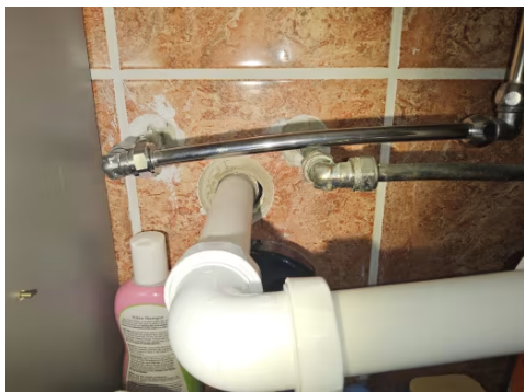
Åpninger i membran rundt rørgjennomføring i vegg.
