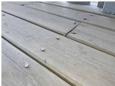
Spikerhoder stikker opp av terrassegulv.
