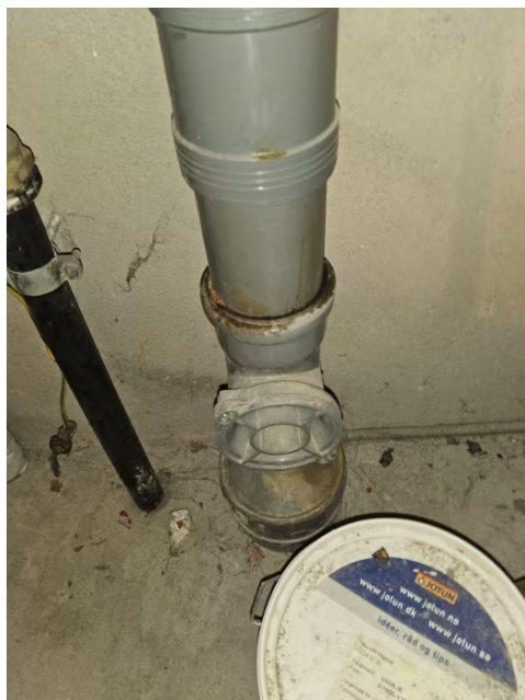
Stakeluke er plassert på kloakkstamme i bod.
