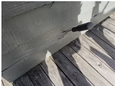
Det registreres stedvise råteskader.
