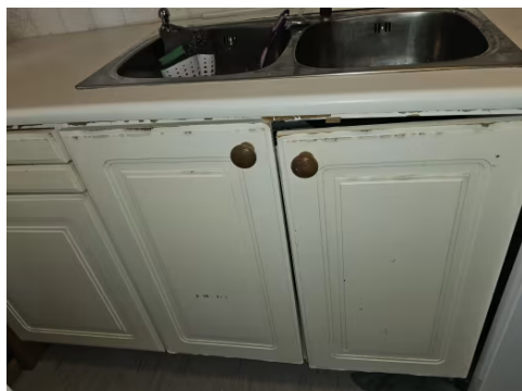
Vaskeromsinnredningen er sterkt slitt.
