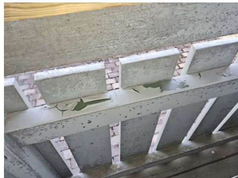
Slitt og avflasket maling på rekkverk.
