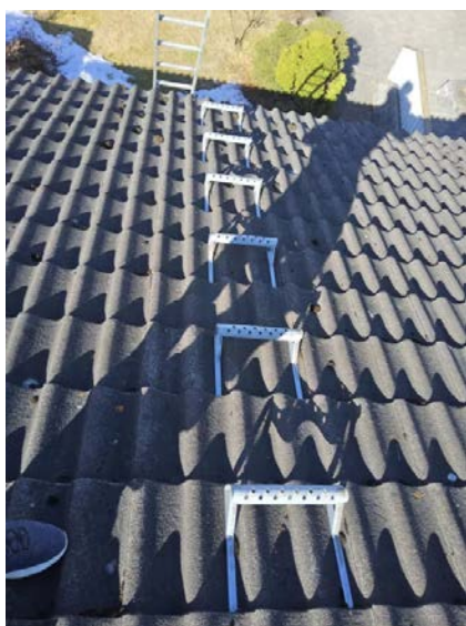
Det er etablert takstige til pipe.
