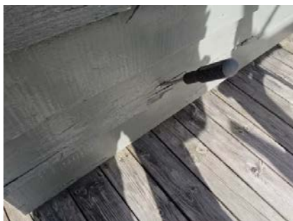
Det registreres stedvise råteskader.
