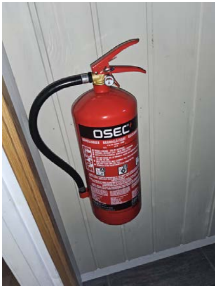
Boligen har et godkjent brannslukningsapparat i hver etasje.
