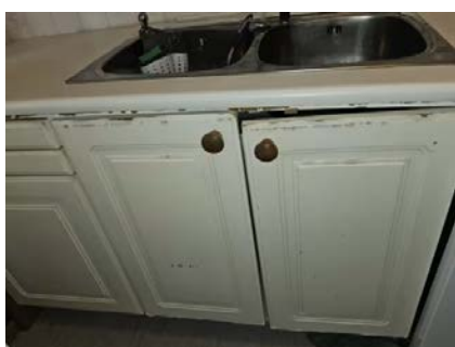
Vaskeromsinnredningen er sterkt slitt.
