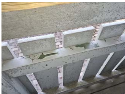
Slitt og avflasset maling på rekkeverk.
