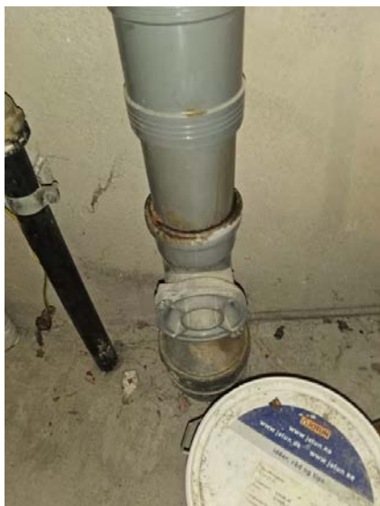
Stakeluke er plassert på kloakkstamme i bod.
