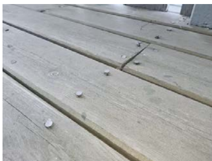
Spikerhoder stikker opp av terrassegulv.
