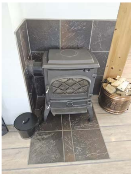
Vedovn med glassdør i stue.
