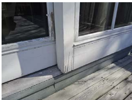
Det registreres værslitte karmen på terrassedør og enkelte vinduer.
