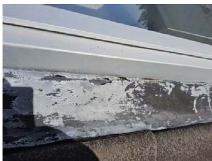
Det registreres revner i beslag rundt rakvinduer.
