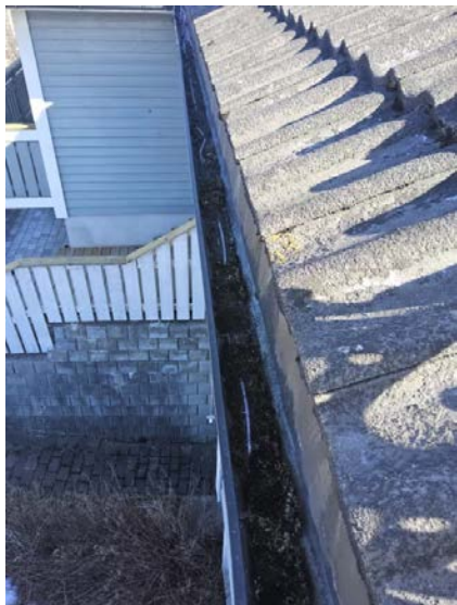
Det registreres oppbygging av mose i takrenner.
