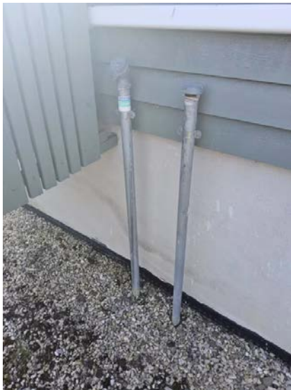
Det registreres påfyllingsrør til oljetank ved boligen.
