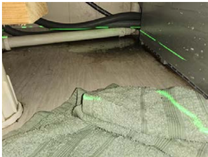
Det registreres stående vann på gulvet etter lekkasje fra oppvaskmaskin.
