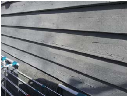
Deler av kledningen har krakelert maling.
