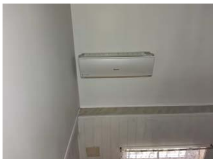
Varmepumpe i trappegang.
