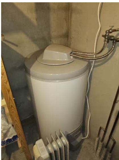
Varmtvannsbereder er plassert i bod i underetasje.
