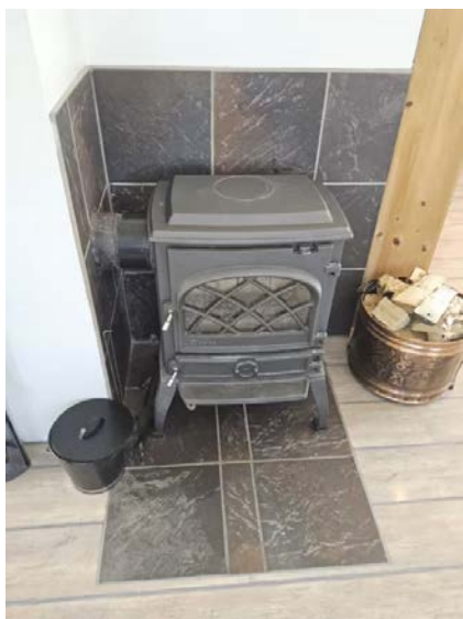
Vedovn med glassdør i stue.
