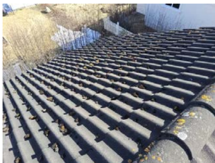
Det registreres noe moseoppbygging på deler av taket.
