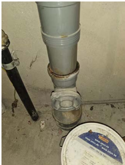
Stakeluke er plassert på kloakkstamme i bod.
