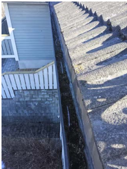
Det registreres oppbygging av mose i takrenner.
