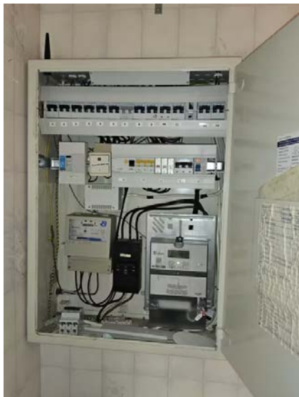
Sikringsskap er plassert på vaskerom.
