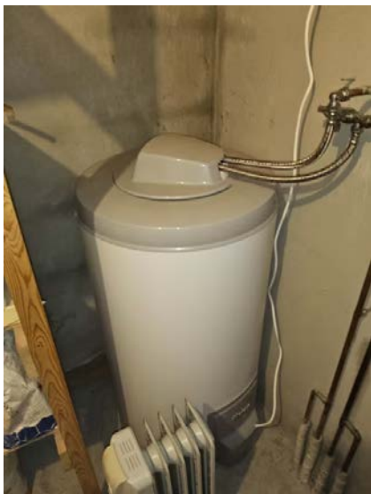
Varmtvannsbereder er plassert i bod i underetasje.
