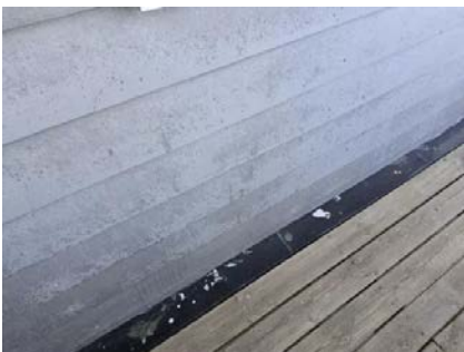
Svertesopp registreres på deler av kledningen.
