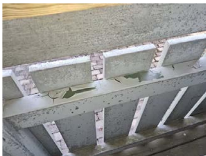
Slitt og avflasset maling på rekkverk.
