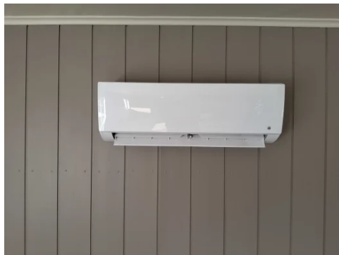
Varmepumpe er plassert i stue.
