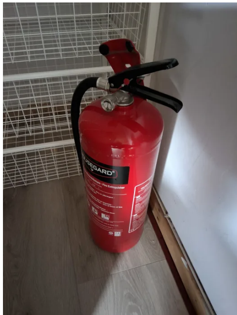
Brannslukningsapparat er plassert i garderobeskap.
