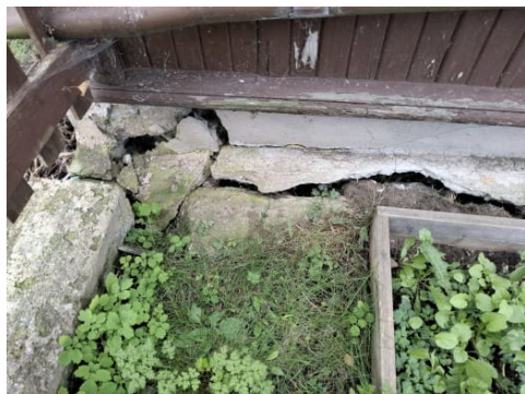
Sprekker og setningsskader på grunnmuren.
