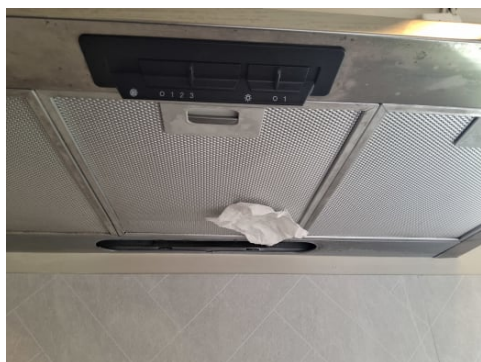
Avtrekkseffekt er testet med papir.
