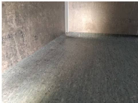
Baderomsplater er montert uten sokkellist og for nærme gulv.
