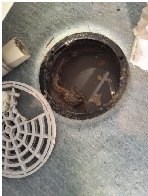
Eldre sluk av støpejern.
