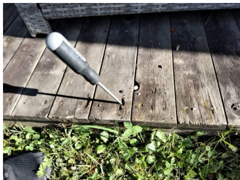
Det registreres råteskader i konstruksjonen.
