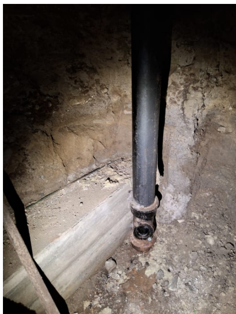
Avløpsrør av støpejern med stakeluke i jordkjeller.
