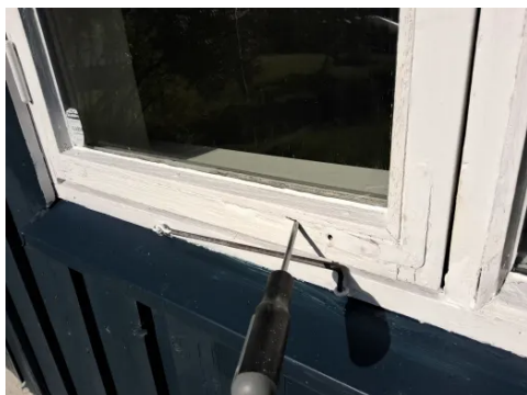
Det registreres råteskader i vinduer
