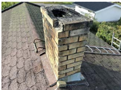
Pipa er forvitret, det registreres løse teglsteiner og synlig armering.
