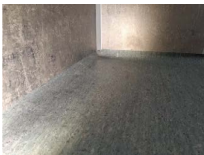
Baderomsplater er montert uten sokkellist og for nærme gulv.
