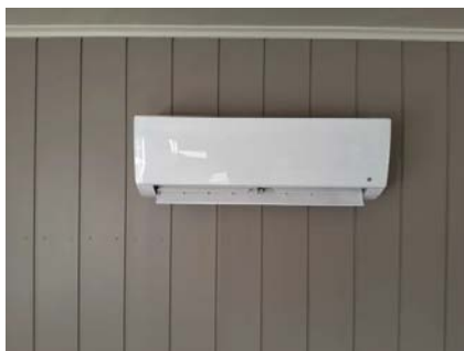
Varmepumpe er plassert i stue.
