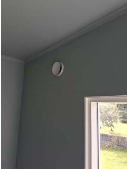
Boligen har naturlig ventilering.
