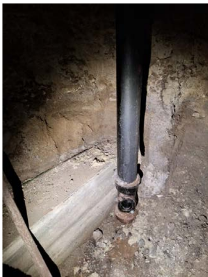
Avløpsrør av støpejern med stakeluke i jordkjeller.
