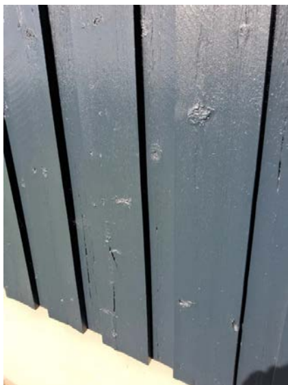
Kledningen er stedvis oppstrukket.
