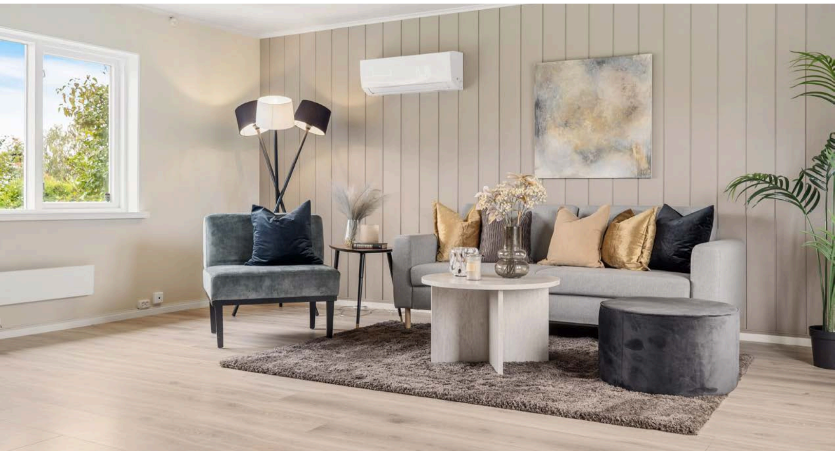
I tillegg varmes boligen opp med varmepumpe montert på vegg i stue og panelovner.
