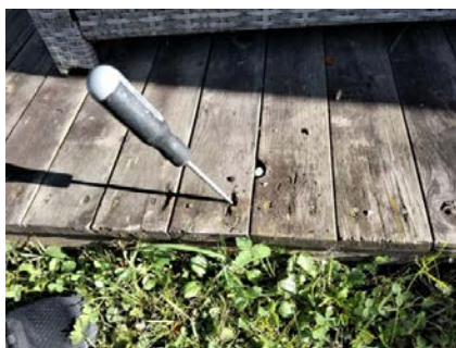
Det registreres råteskader i konstruksjonen.
