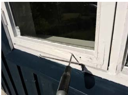
Det registreres råteskader i vinduer
