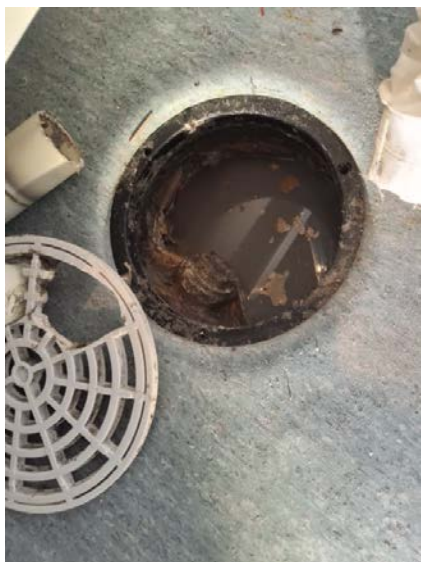
Eldre sluk av støpejern.
