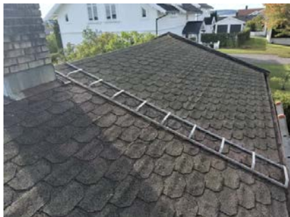
Det er etablert takstige som er forankret i konstruksjonen.
