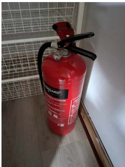
Brannslukningsapparat er plassert i garderobeskap.
