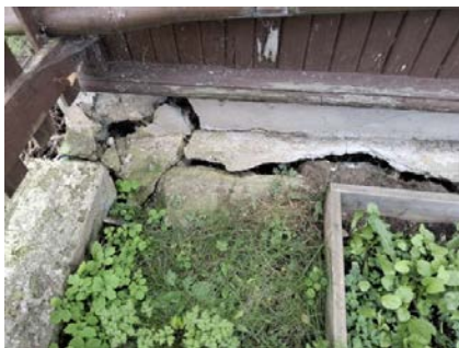
Sprekker og setningsskader på grunnmuren.
