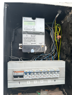
Sikringskap med automatsikringer.
