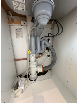
Røropplegg i kjøkkenbenk med Waterguard
