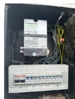
Sikringsskap med automatsikringer.
