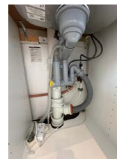
Rørøpplegg i kjøkkenbenk med Waterguard
