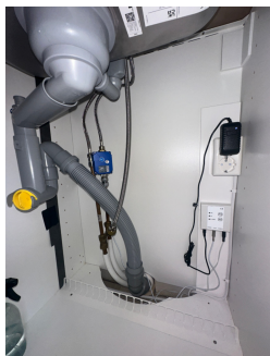
Røropplegg i kjøkkenbenk med Waterguard
