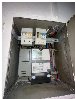
Sikringsskap med automatsikringer.
