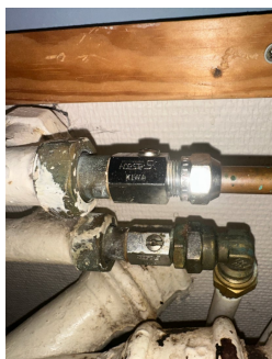
Stoppekraner plassert på soverom
