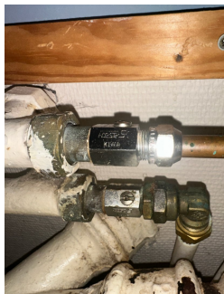
Stoppekraner plassert på soverom
