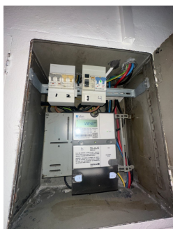
Sikringsskap med automatsikringer.
