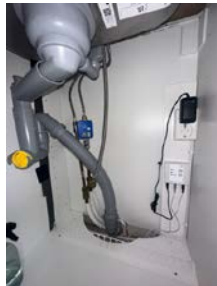
Røropplegg i kjøkkenbenk med Waterguard
