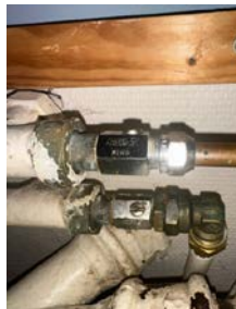
Stoppekraner plassert på soverom
