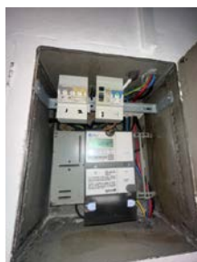
Sikringsskap med automatsikringer.
