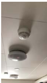
Manglende 230V brannvarsler i loftetasje.
