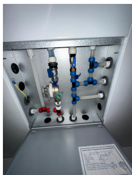
Samleskap med rørkurser og stoppekraner
