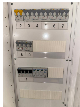
Sikringsskap med automatsikringer.
