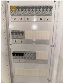
Sikringsskap med automatsikringer.
