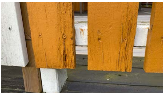
Råteskade i rekkverksbord.
