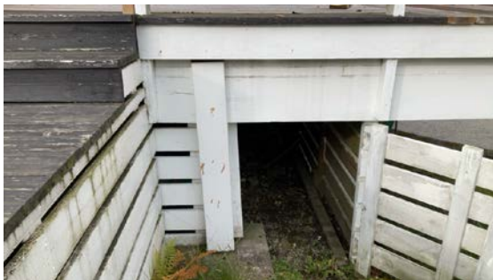
Synlig skjevhet i stolpefundament.
