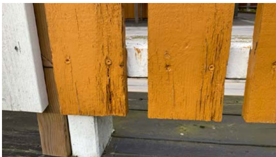
Råteskade i rekkverksbord.
