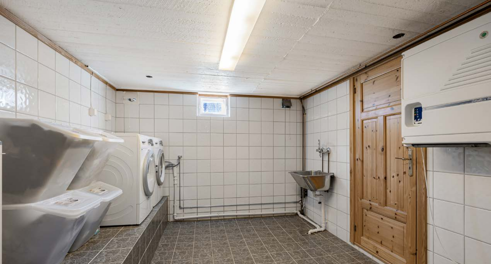
I underetasjen har boligen et eget vaskerom med fliser, gulvvarme og utslagsvask.
