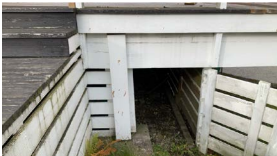
Synlig skjevhet i stolpefundament.
