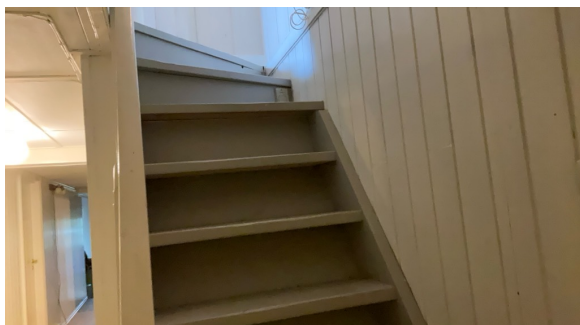
Det mangler håndløper på vegg i trappeløpet.
