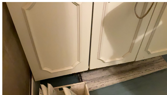
Fuktskader på innredningen.
