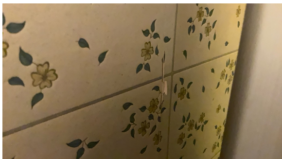
Utette skjøter på vegg.
