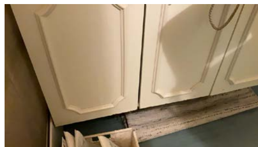
Fuktskader på innredningen.
