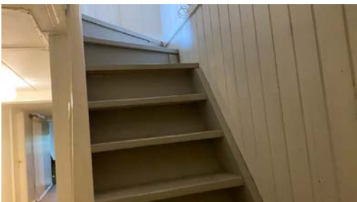
Det mangler håndløper på vegg i trappeløpet.
