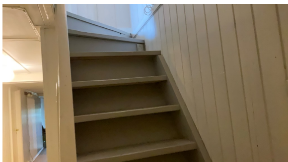
Det mangler håndløper på vegg i trappeløpet.
