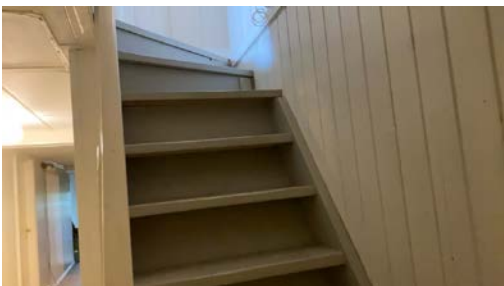
Det mangler håndløper på vegg i trappeløpet.
