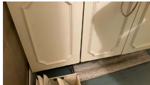
Fuktskader på innredningen.
