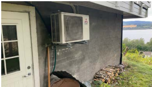
Viktig å lede vann fra varmepumpen bort fra grunnmuren.
