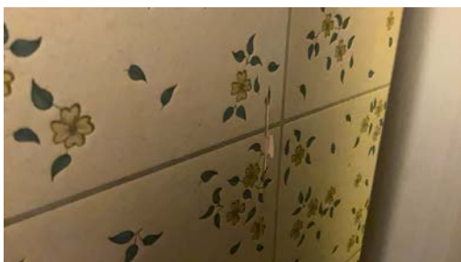
Utette skjøter på vegg.
