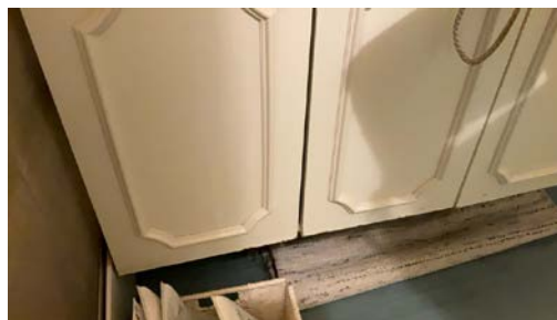
Fuktskader på innredningen.
