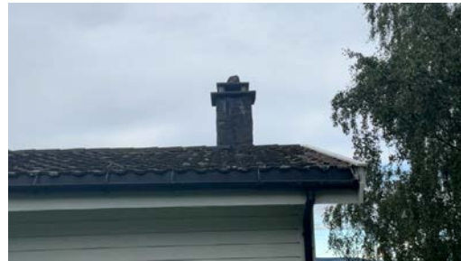
Det er ikke montert pipebeslag. Ved manglende beslag er det fare for at vann trenger inn i takkonstruksjon og kan føre til fuktproblemer, som igjen kan forårsake mugg og råte.
