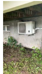
Viktig å lede vann fra varmepumpen bort fra grunnmuren.
