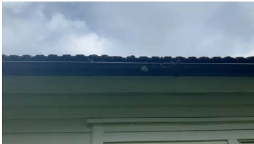
Flassing på takrenner/beslag.
