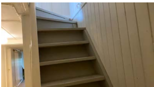
Det mangler håndløper på vegg i trappeløpet.
