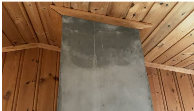
Fuktskjolder på pipestamme
