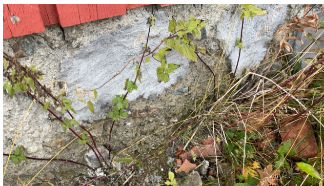
Forvitring av mur
