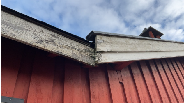
Slitasje på vindskier
