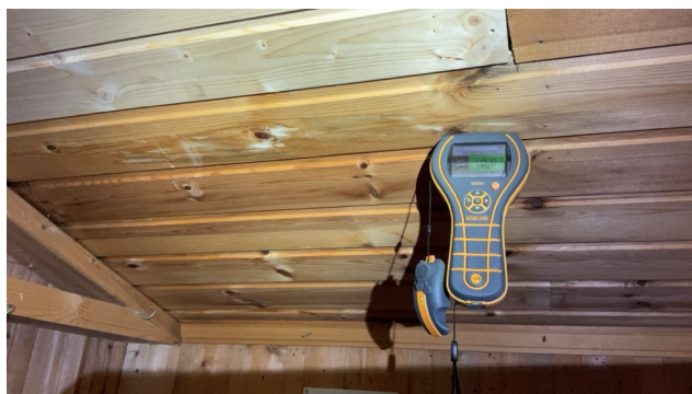
Det er lukket tidligere pipegjennomføring av pipe fra soverom, det er registrert gjenstående arbeid i vegg og gulv. Fuktskjolder i himling ved område med muggslør, ved fuktmåletaking under befaringsstidspunkt var det ikke fuktutslag og må holdes under tilsyn
