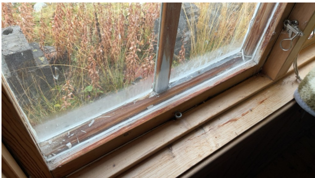
Vinduer er slitte
