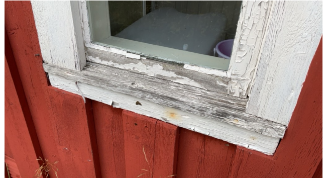
Vinduer er slitte og preget av elde, må påregnes utskifting
