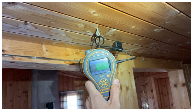
Fuktskjolder i himling fra kjøkken, ved fuktmåletaking under befarings var det ikke utslag og må holdes under tilsyn
