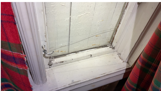
Sprekk i glass
