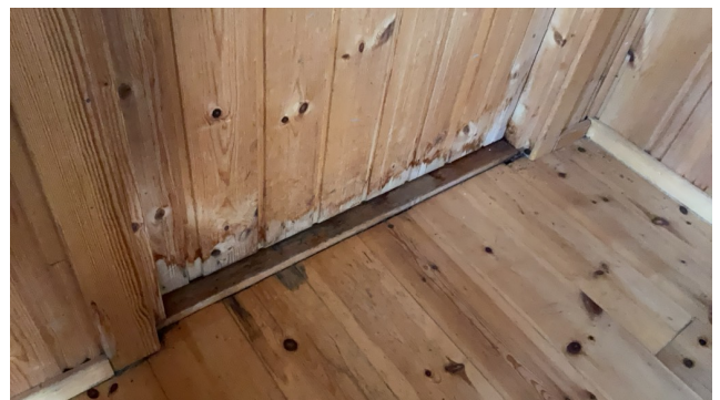
Fuktskjolder på ytterdør til stue
