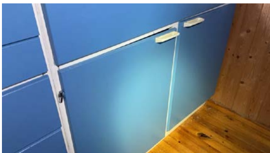
Skjevheter i innredning/skapedør
