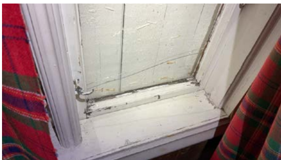
Sprekk i glass
