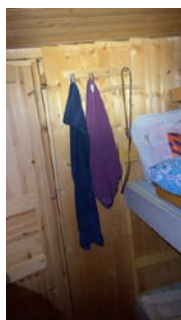
Betydelige skjevheter i konstruksjoner
