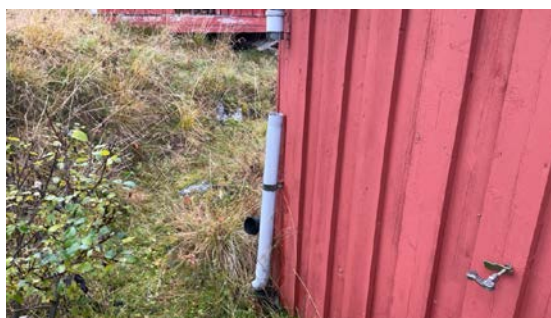
Fuktpåvirkning fra takvann
