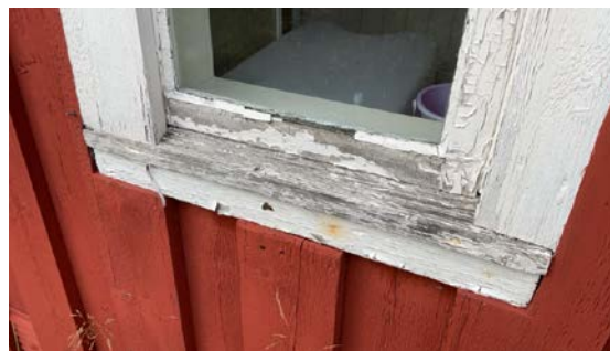
Vinduer er slitte og preget av elde, må påregnes utskifting
