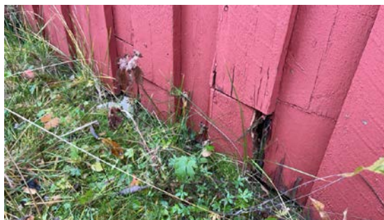
Det er registrert råteskader i ytterkledning og veggkonstruksjon, spesielt på overside der vegg ligger ned mot gulv og fuktoppsug fra terreng og ved nedbør legger vann/smeltevann seg inntil vegg
