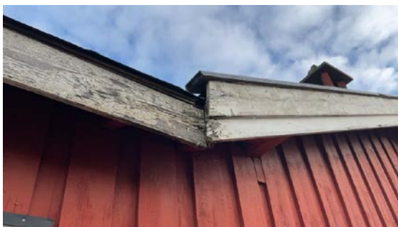
Slitasje på vinds kier
