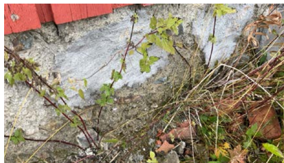
Forvitring av mur
