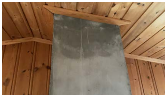
Fuktskjolder på pipestamme
