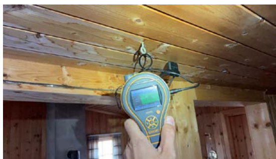
Fuktskjolder i himling fra kjøkken, ved fuktmåletaking under befarig var det ikke utslag og må holdes under tilsyn
