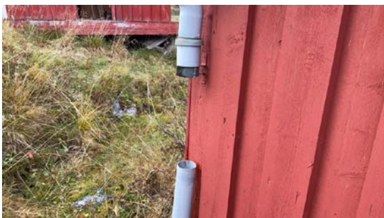
Avvik på nedløp, ikke tilstrekkelig bortledning og vil føre til fuktpåkjenning med potensiell skade i vegg
