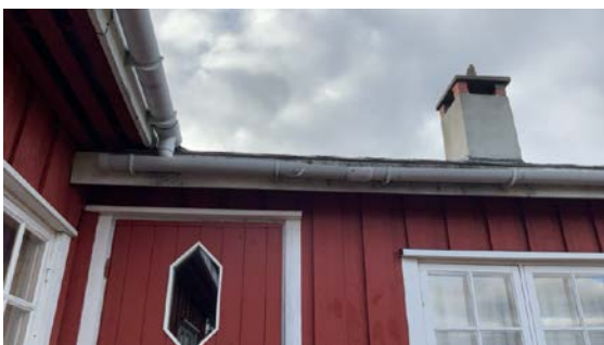
Skade på takrenne
