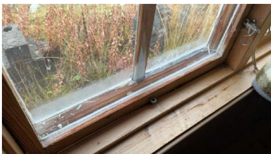
Vinduer er slitte
