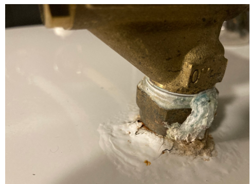
Irr på kobling, varmtvannsbereder
