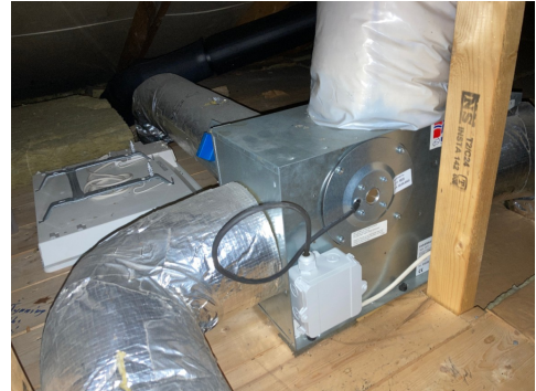
Motor til ventilasjon er montert på loft
