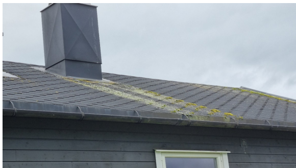
Taket er noe mosegrodd.
