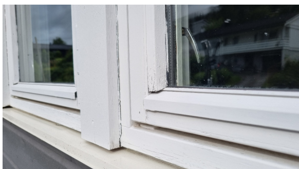
Vindu er værslitt.
