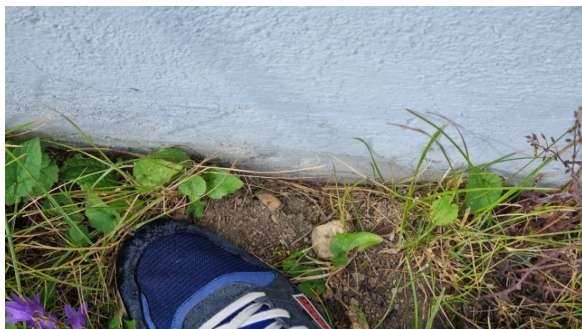
Det ble ved befarings ikke registrert synlig grunnmursplast/fuktsikring.
