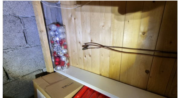
Fyringsrør går ut gjennom grunnmur, denne delen grenser mot bod under garasjen.
