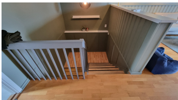
Det mangler håndløper på vegg i trappeløpet.
