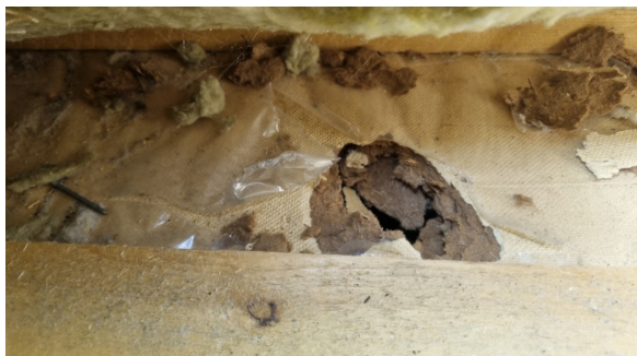
Det er utettheter i dampsperre.
