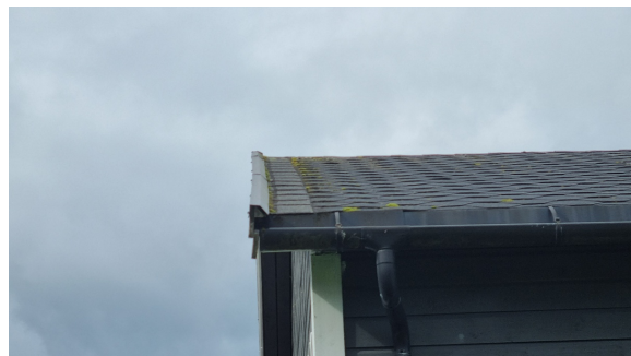
Det er lagt en remse med nyere takpapp.
