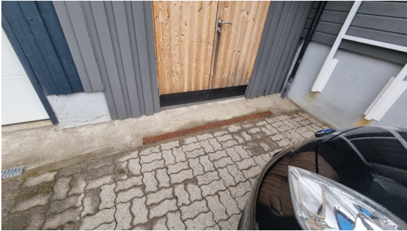
Dreneringsrenne med varmekabel.
