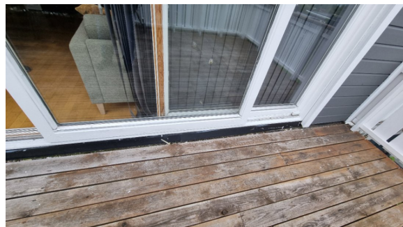
Skyvebalkongdør er værslitt og har innvendig bruksslitasje.
