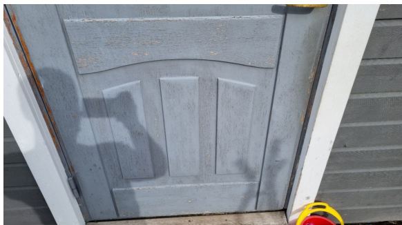
Ytterdør er værslitt.
