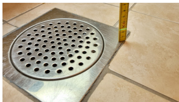
Det ble registrert motfall fra sluk.
