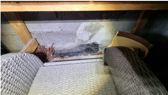
Ingen synlig oljetank/dagtank.
