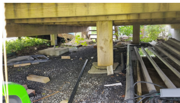
Det er registrert provisoriske understøtter av bjelkekapp som er fundamentert på steinheller under terrassen.
