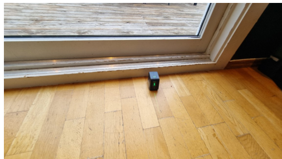
Noe overflateslitasje i parkett.
