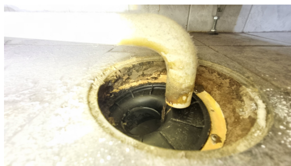
Plastsluk under dusjkabinett.
