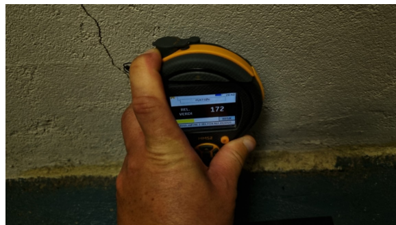
Ingen unormale fuktverdier ble registrert ved befarings, men rom under terreng kombinert med drenering/fuktsikring er å anse som en risikokonstruksjon
