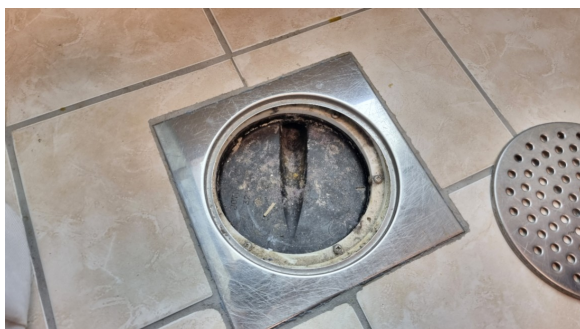
Sluken har ukjent utførelse angående membran, ingen dokumentasjon foreligger.
