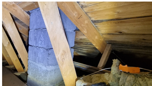
Fuktmerker i taktro på
