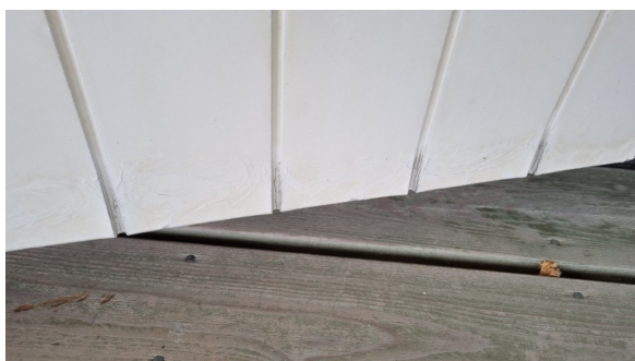
Balkongdør i sokkeletasjen har fuktsvell i dørblad.
