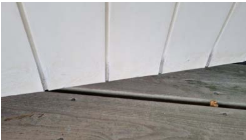
Balkongdør i sokkeletasjen har fuktsvell i dørbblad.
