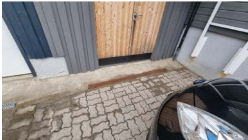
Dreneringsrenne med varmekabel.
