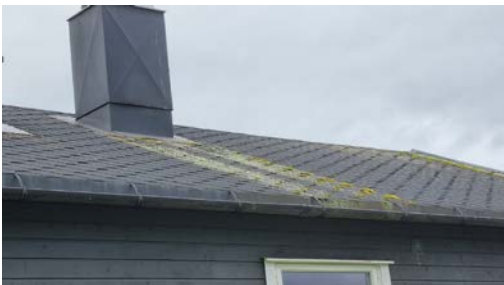
Taket er noe mosegrodd.
