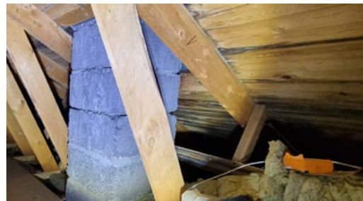
Fuktmerker i taktro på
