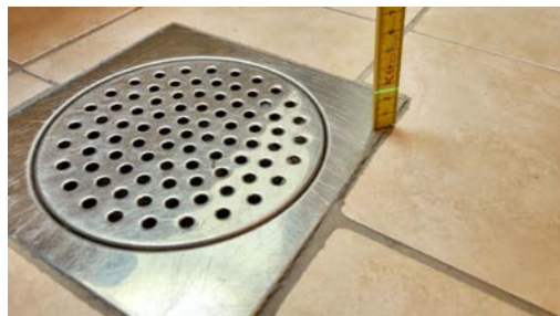
Det ble registrert motfall fra sluk.
