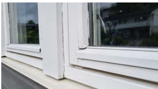
Vindu er værslitt.
