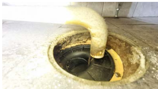
Plastsuk under dusjkabinett.
