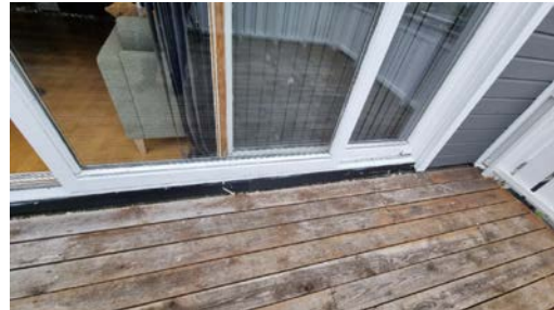
Skyvebalkongdør er værslitt og har innvendig bruksslitasje.
