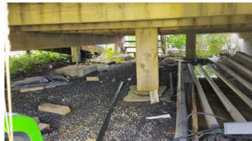
Det er registrert provisoriske understøtter av bjelkekapp som er fundamentert på steinheller under terrassen.
