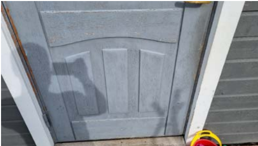
Ytterdør er værslitt.
