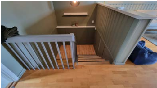
Det mangler håndløper på vegg i trappeløpet.
