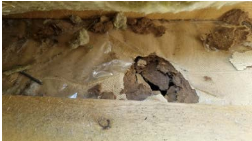
Det er utettheter i dampsperre.
