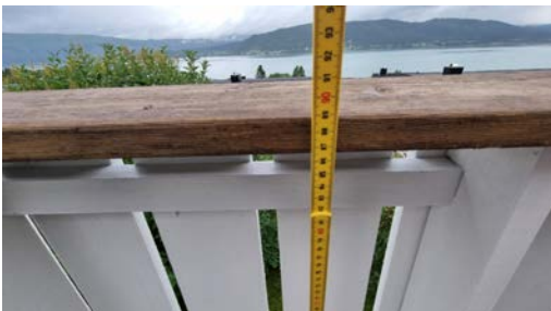
Begge terrassene har rekkverk som er lavere enn 100 cm.
