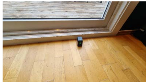
Noe overflateslitasje i parkett.
