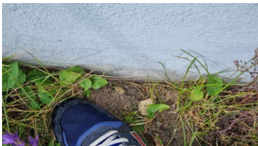
Det ble ved befarung ikke registrert synlig grunnmursplast/fuktsikring.
