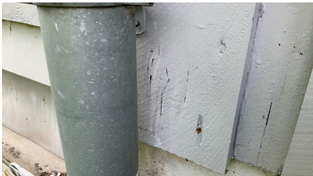
Råte i kledningsbord ved takrennedløp.
