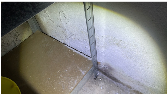
Bod/teknisk rom ved garasjen.
