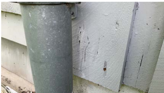
Råte i kledningsbord ved takrennenedløp.
