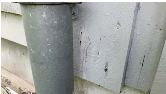
Råte i kledningsbord ved takrennenedløp.
