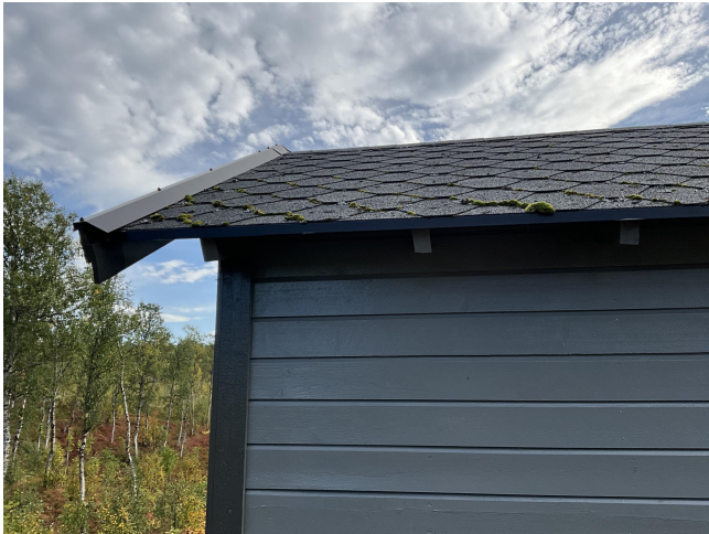
Uthuset har ikke takrenner.
