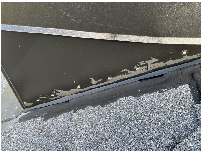
Sprekk eller riss i fuge rundt pipehatt.
