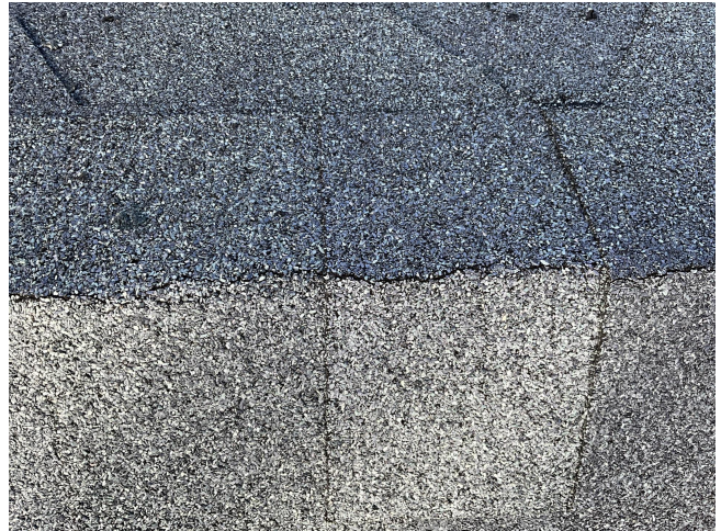
Slitasje eller aldring av takbelegg.
