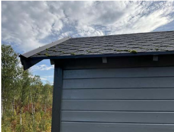
Uthuset har ikke takrenner.
