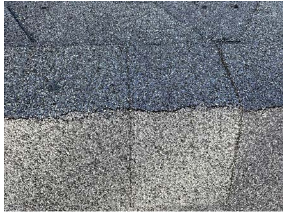
Slitasje eller aldring av takbelegg.
