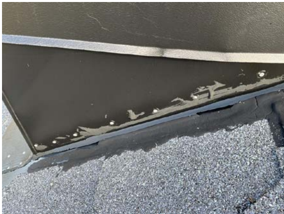
Sprekk eller riss i fuge rundt pipehatt.
