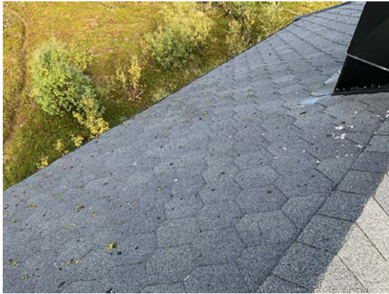
Slitasje eller aldring av takbelegg. Alge- eller mosevekst på takflaten.
