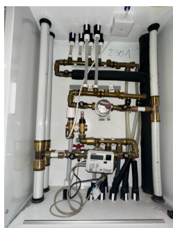
Samleskap med rørkurser og stoppekraner leilighet
