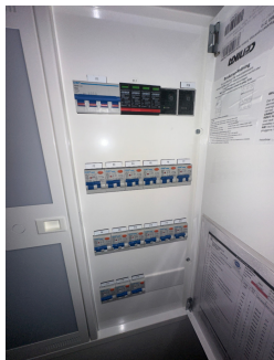
Sikringsskap med automatsikringer.
