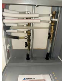
Samleskap med rørkurser og stoppekraner hybel
