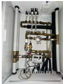
Samleskap med rørkurser og stoppekraner leilighet
