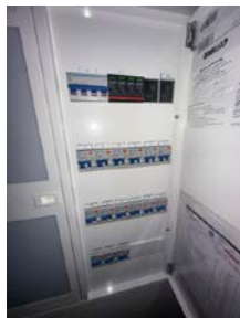
Sikringsskap med automatsikringer.
