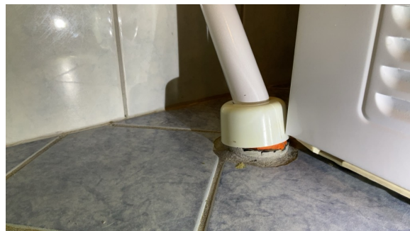
Utilfredstillende tetting ved rørgjennomganger
