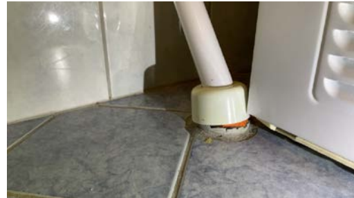
Utilfredstillende tetting ved rørgjennomganger
