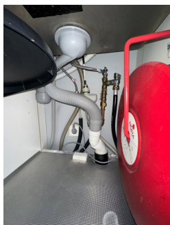
Røropplegg i kjøkkenbenk med Waterguard
