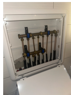
Samleskap med rørkurser og stoppekraner
