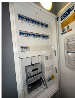
Sikringsskap med automatsikringer.
