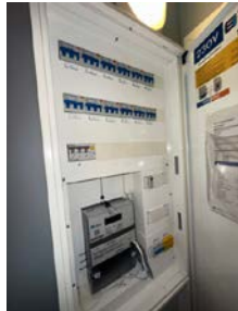
Sikringsskap med automatsikringer.
