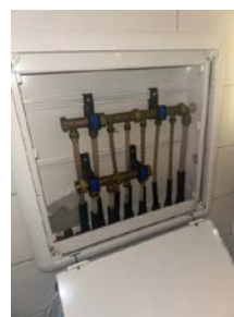
Samleskap med rørkurser og stoppekraner
