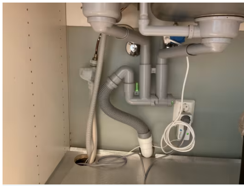
Avløpsrør under kjøkkenbenk.
