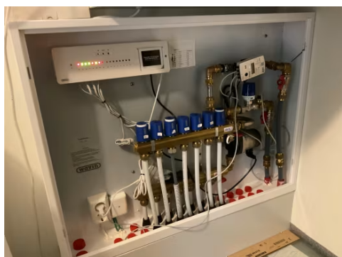
Fordelerskap til gulvvarme.
