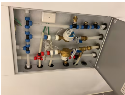
Fordelerskap plassert i tak på badet.
