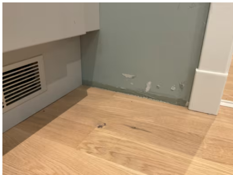
Manglende listverk på kjøkken.
