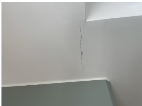
Eksempel på sprekk i maling.
