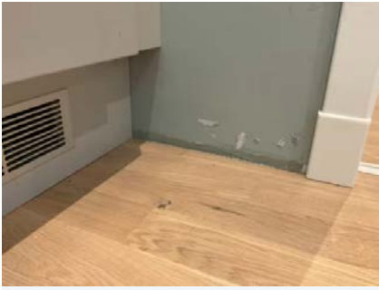
Manglende listverk på kjøkken.
