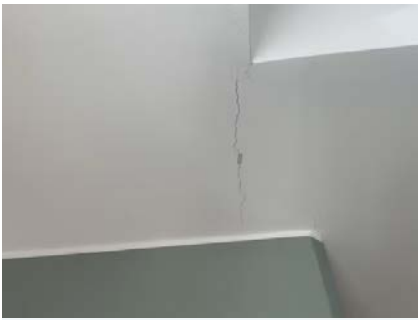
Eksempel på sprekk i maling.
