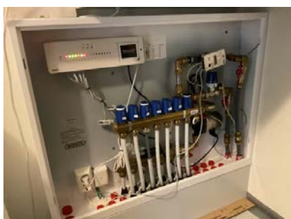
Fordelerskap til gulvvarme.
