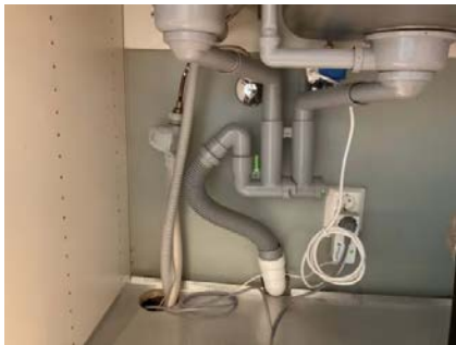
Avløpsrør under kjøkkenbenk.
