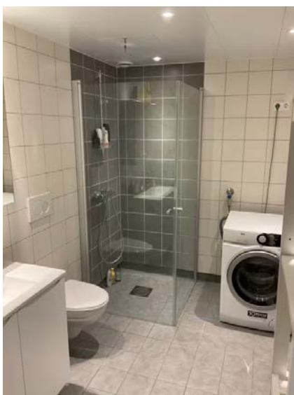
Dusj, wc og opplegg for vaskemaskin.
