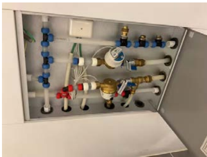
Fordelerskap plassert i tak på badet.
