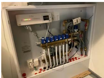
Fordelerskap til gulvvarme.
