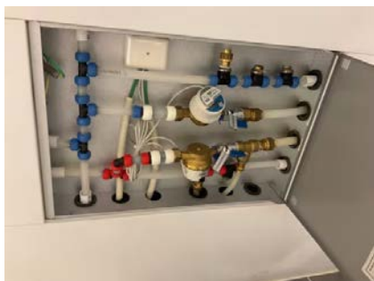
Fordelerskap plassert i tak på badet.
