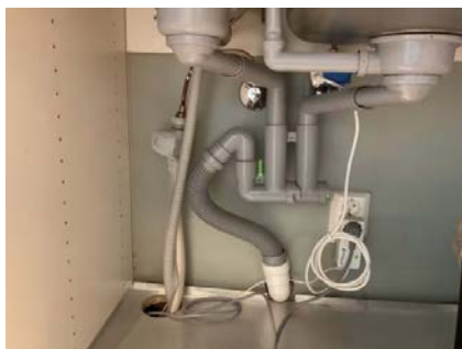
Avløpsrør under kjøkkenbenk.
