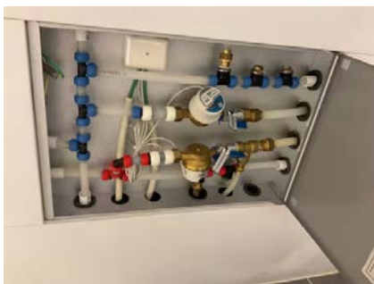
Fordelerskap plassert i tak på badet.
