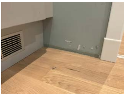
Manglende listverk på kjøkken.
