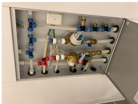
Fordelerskap plassert i tak på badet.
