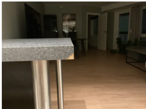
Skade på benkeplate
