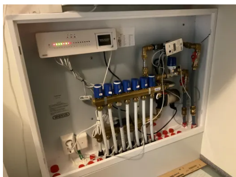
Fordelerskap til gulvvarme.
