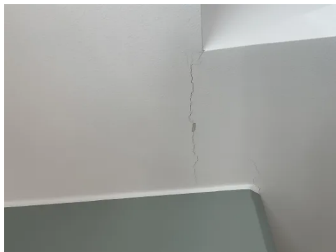
Eksempel på sprekk i maling.
