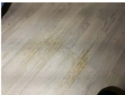
Slitasje i parkettgulv på soverom
