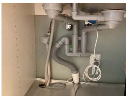
Avløpsrør under kjøkkenbenk.
