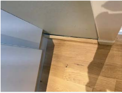
Dårlig innfesting på list ved kjøkken.
