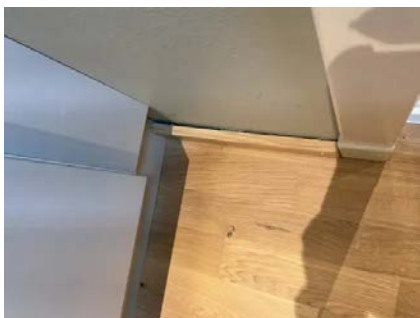
Dårlig innfesting på list ved kjøkken.
