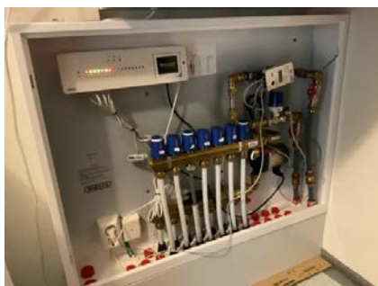
Fordelerskap til gulvvarme.
