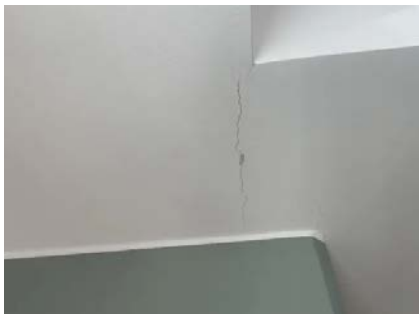
Eksempel på sprekk i maling.
