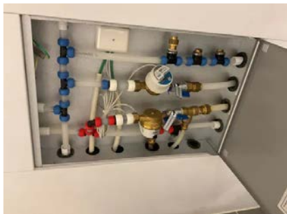
Fordelerskap plassert i tak på badet.
