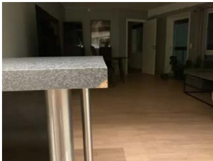
Skade på benkeplate
